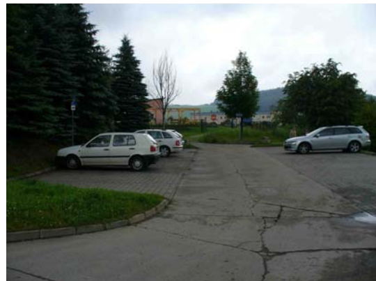
Schäden an Wohnwegen, Am Fichtbusch
